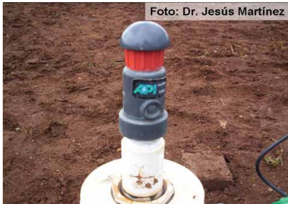
Válvula de aire al terminar el sistema de riego por goteo.
